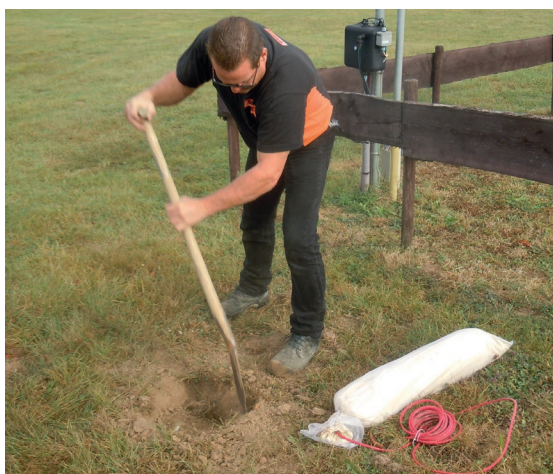
Een nieuwe kathodische bescherming voor onze benzinetank
