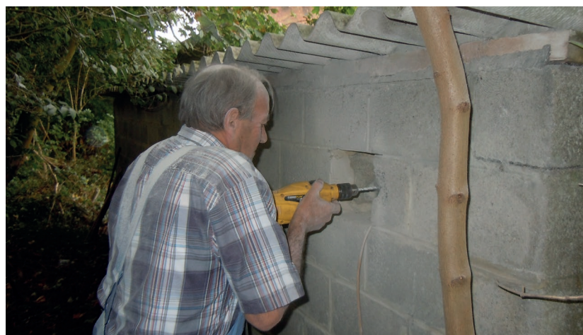
Çoiske bij het maken van de verluchtingsgaten in het gebouw gevaarlijke producten
